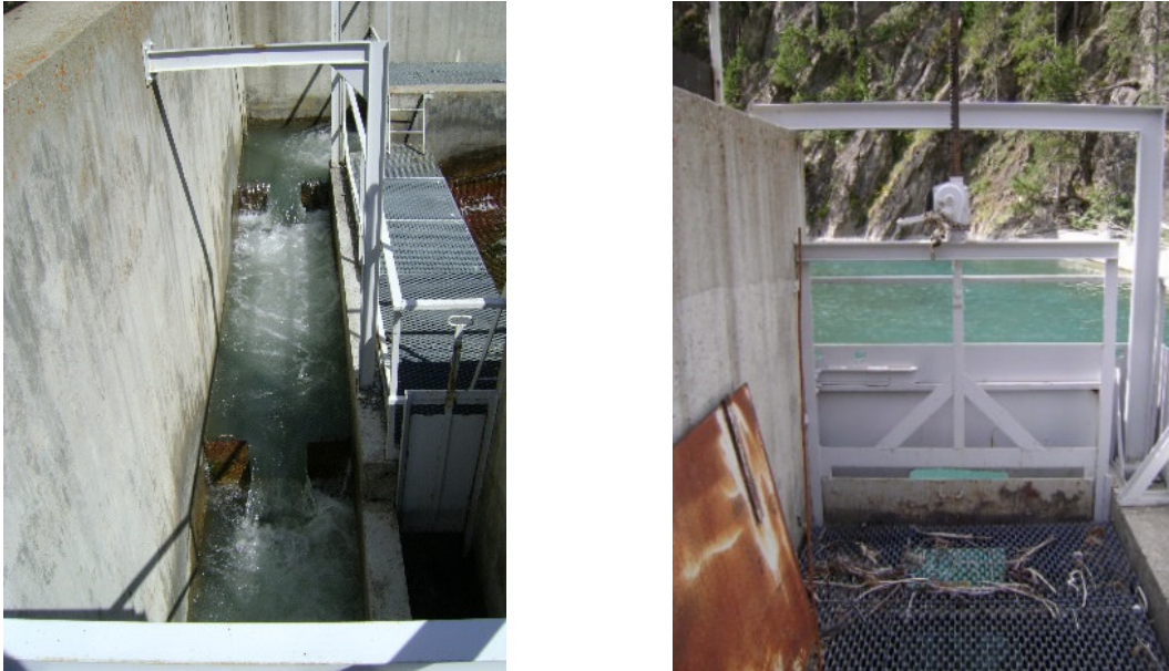
Figure 5 : Bacs n°2, 3 et 4 de la passe à poissons et vanne de contrôle du débit entrant
