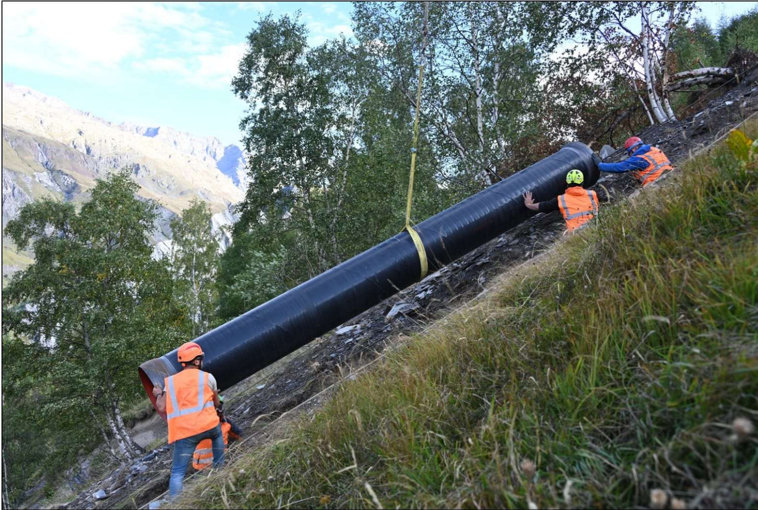
Figure 3 - Exemple de pose d'une section de conduite forcée en acier soudé (crédit photo SERHY)
