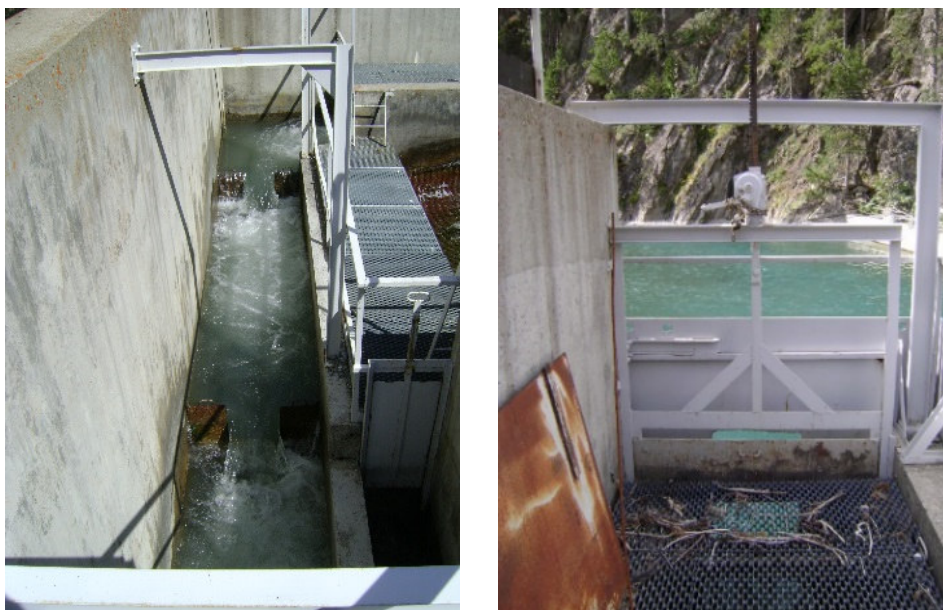
Figure 21 - Bacs n°2, 3 et 4 de la passe à poissons et vanne de contrôle du débit entrant
