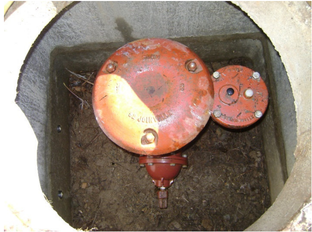
Figure 74 - Ventouse de la conduite forcée
