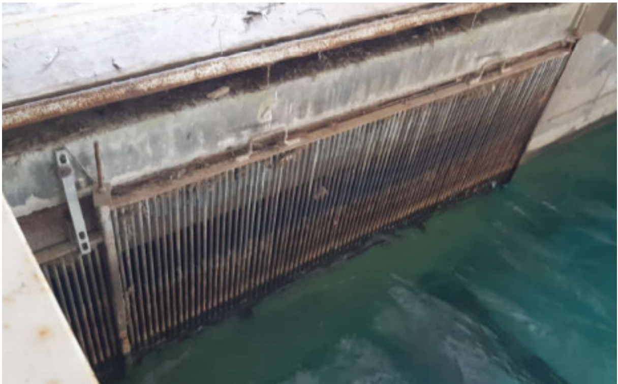
Figure 14 - Grilles placées entre le dessableur et le bassin de mise en charge
