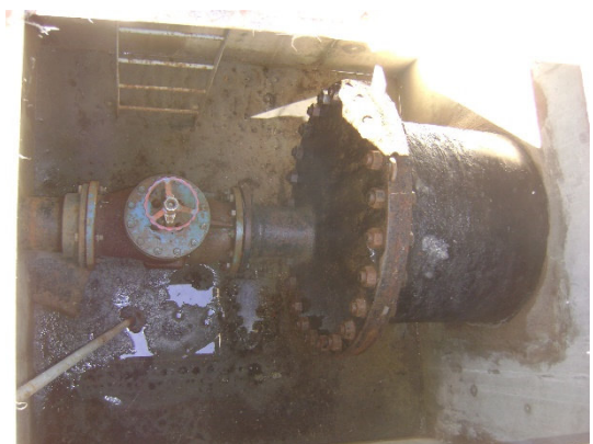
Figure 75 - Vanne de vidange conduite - usine
